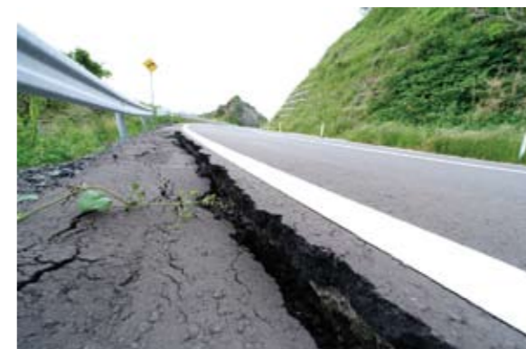
道路に大きな亀裂が入り、段差ができています
