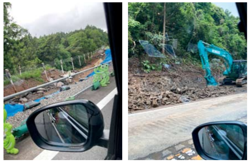
能登半島に入ると、所々に崩落した道路が見られる
